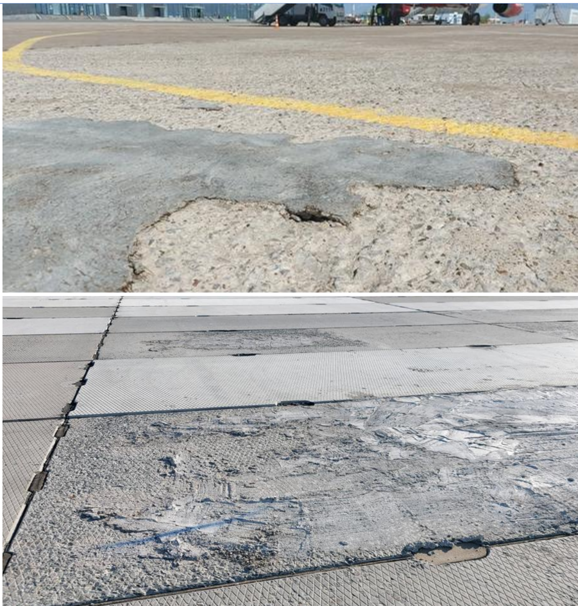
Рис.2: некачественный ремонт жестких (бетонных) покрытий, без соблюдения технологии СМР, с последующим образованием продуктов разрушения покрытий - FOD
